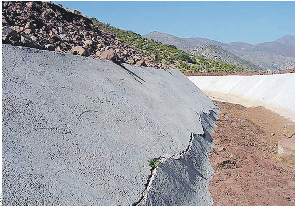
Un ejemplo de compactación deficiente: grietas laterales en un canal.
