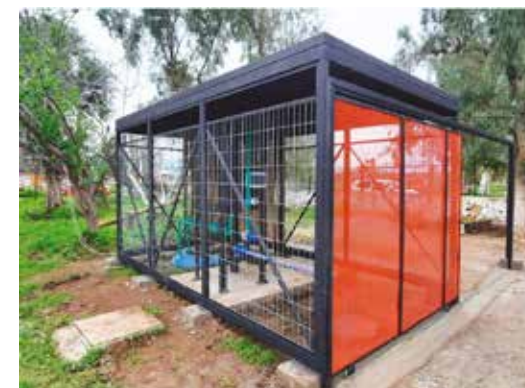
Planta rural de reúso de aguas grises. Fuente: Archivo personal Eduardo Leiva.
